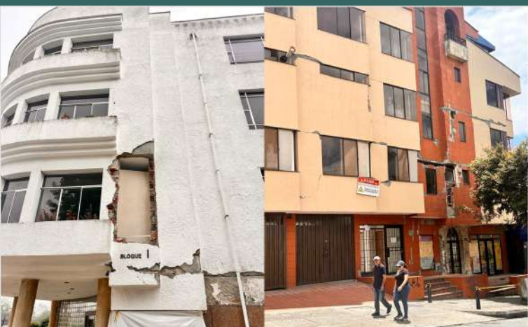
■ Daños en edificaciones de la ciudad de Manizales, causados por el terremoto del 10 de agosto de 2026. Fotografías: Angélica Aldana.
